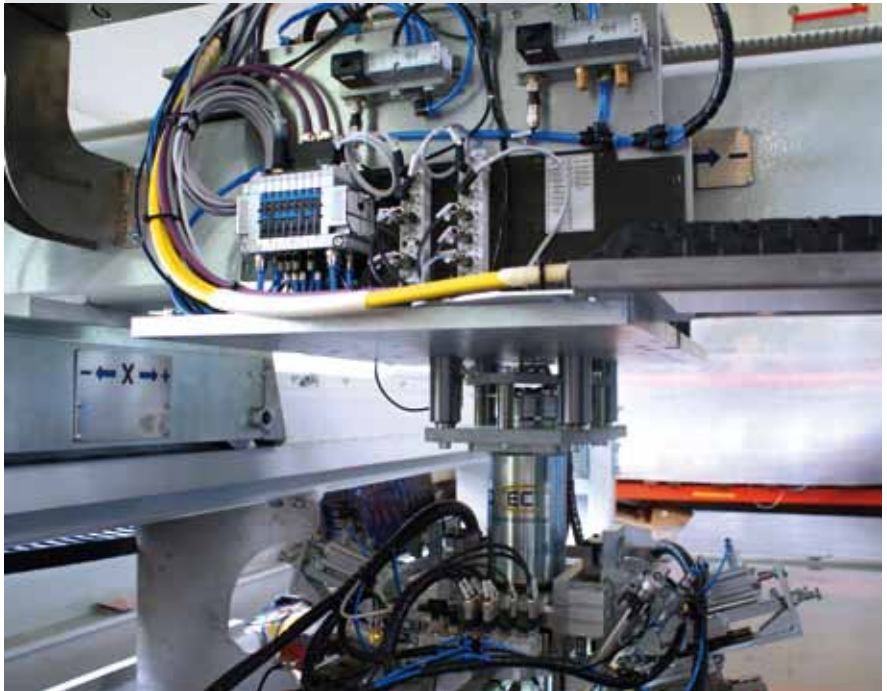
Blick hinter die Kulissen: Automatisierungstechnik vom Feinsten
