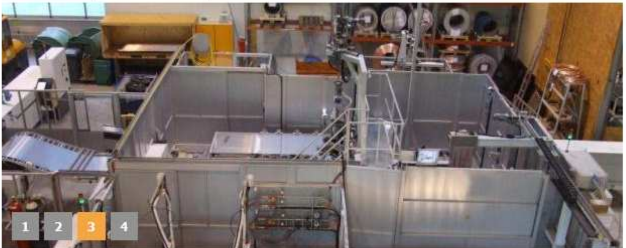
Gesamtansicht der TiSUN Absorberschweißanlage (Foto: TiSUN)
